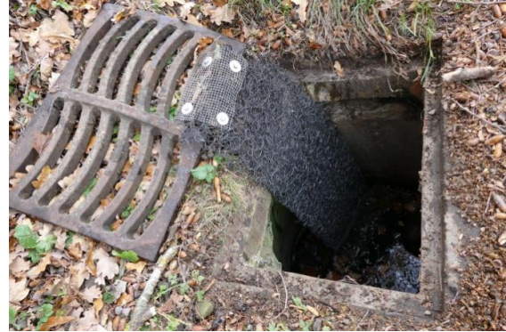
Abbildung 4; Angebrachte Drainagematte an offenem Abwasserschachtdeckel 4
