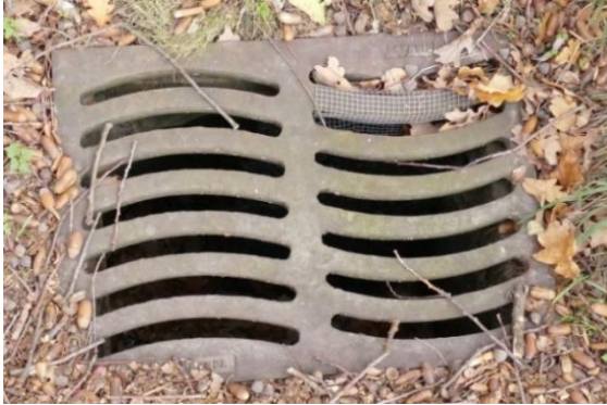
Abbildung 3; sichtbare Ausstieghilfe bei geschlossenem Abwasserschachtdeckel 3
